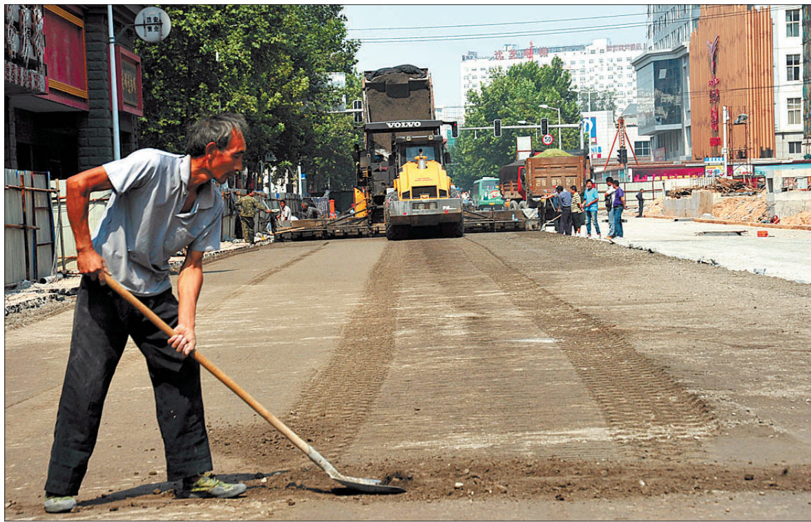
昨日,在纱厂南路人防工程施工现场,市政建设集团的工人们正在摊铺道路路基水泥稳定层。目前,为尽早缓解该地段的交通通行压力,施工人员正昼夜加紧施工,力争在本月底让该路段恢复通车。纱厂南路地下人防工程北起唐宫路口,南至凯旋路口,全段共设17个通道出入口。 记者 高山岳 李卫超 通讯员 贾光明 摄影报道
