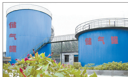
光瑞科技的沼气储气罐。
