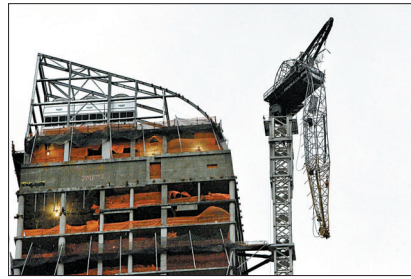
起重机吊臂在飓风中折断。
