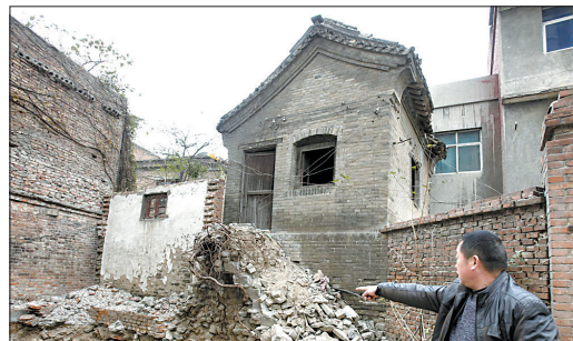
门楼东侧原有的楼梯已经垮塌。
