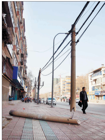
连着电线的半截电线杆悬空着
