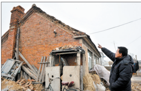
柳条寨镇受损的房屋
