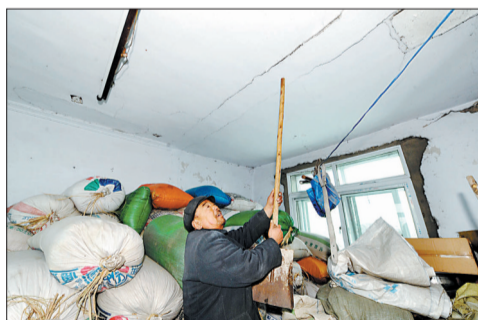
柳条寨镇一家的房屋天花板被震裂
