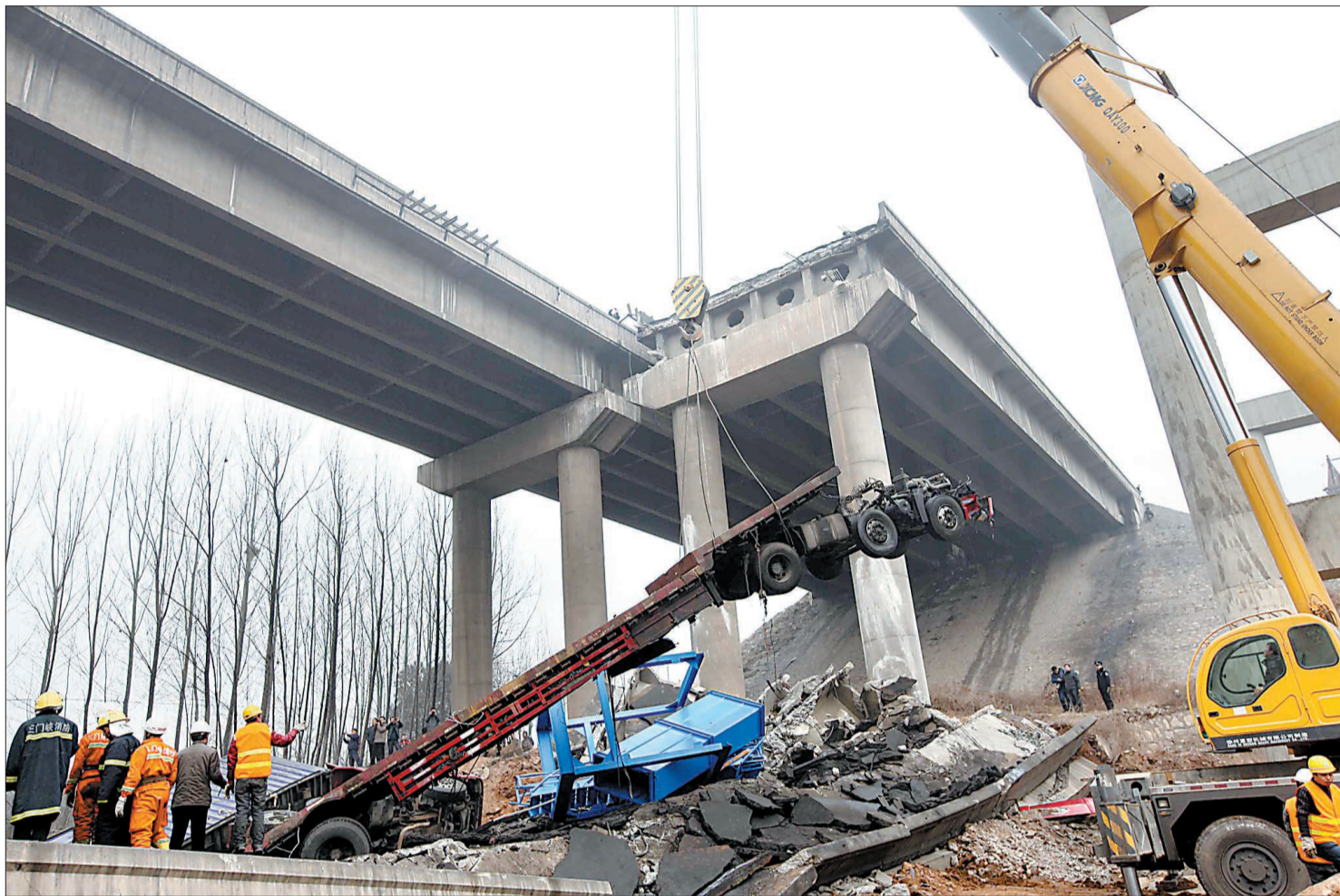
大桥南半幅坍塌
