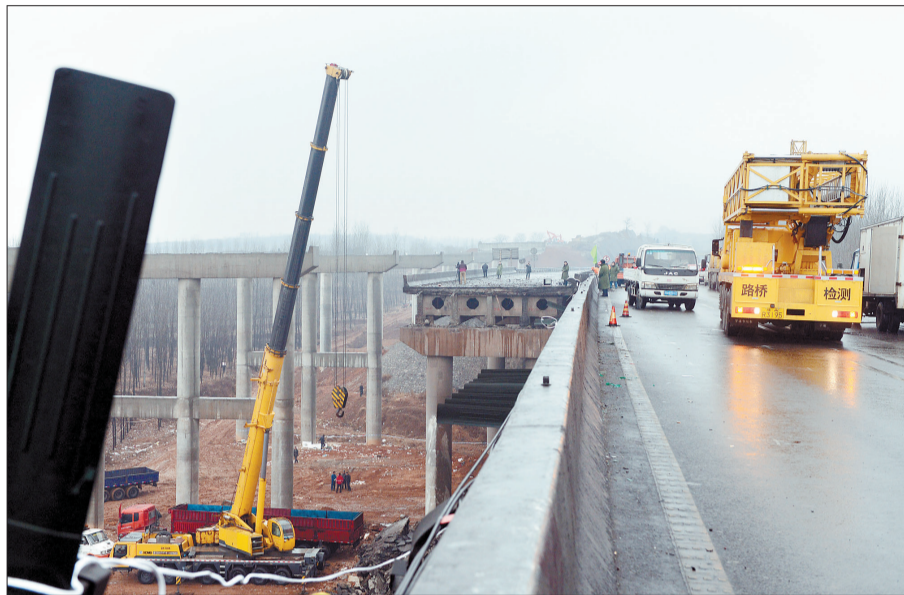
连霍高速义昌大桥北半幅桥梁结构进行通车安全性评估和维修 新华社记者 赵鹏 摄
