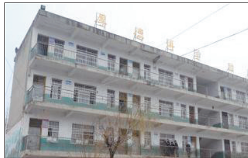
发生事故的教学楼
