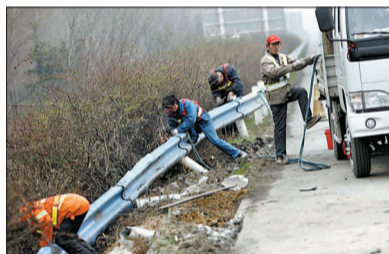
就是这段被压倒的护栏,阻挡客车继续滑落
