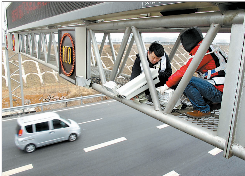
来自杭州某公司的工程技术人员正在安装高清监控设备
