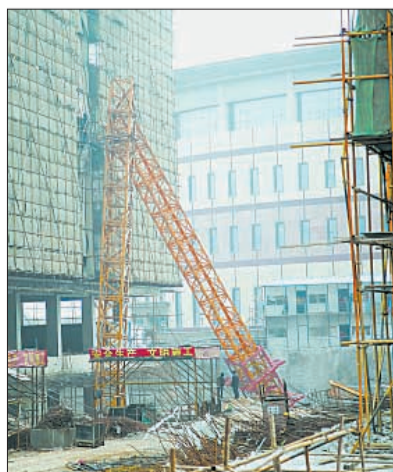
塔吊被大风吹“折腰”
