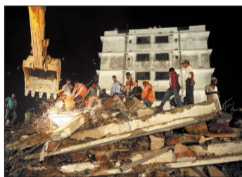
印度一在建大楼坍塌
