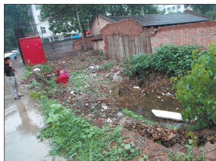
大明渠与忠义街交叉处淤塞较严重
