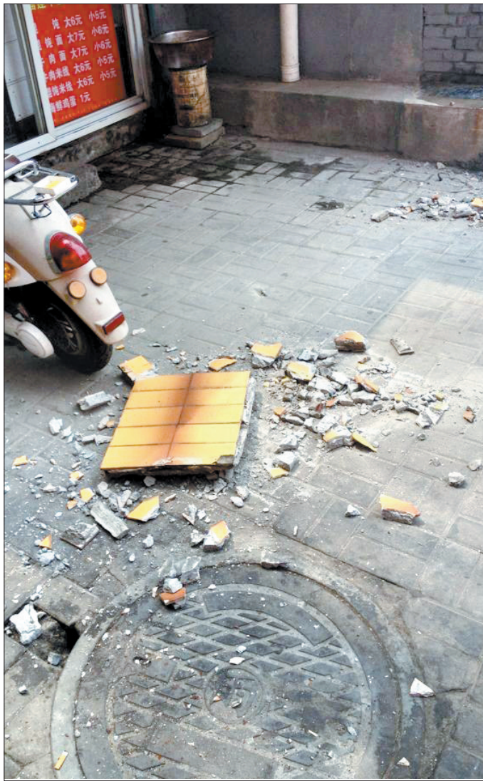
从大楼楼顶处掉落的墙体
