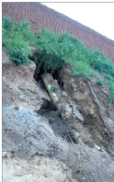
东出口雨水泵一段排水管道被毁
