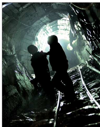
隧洞内安装有通风管、高压水管、抽水管等设施
