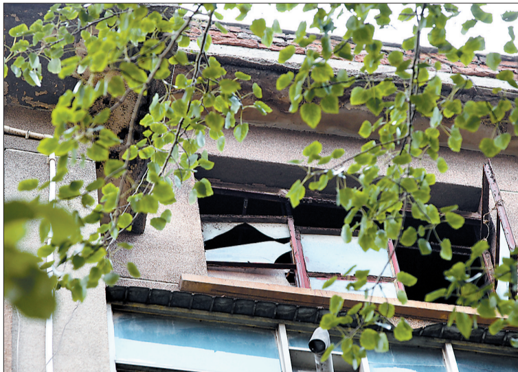
楼上脱落的墙皮把窗户玻璃都打破了
