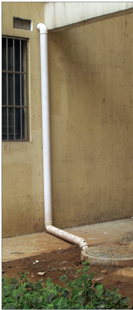
2号楼外接的下水管子
