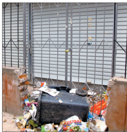
小区围墙被砸开一个大豁口,为表示不满,居民将垃圾堆放在此处
