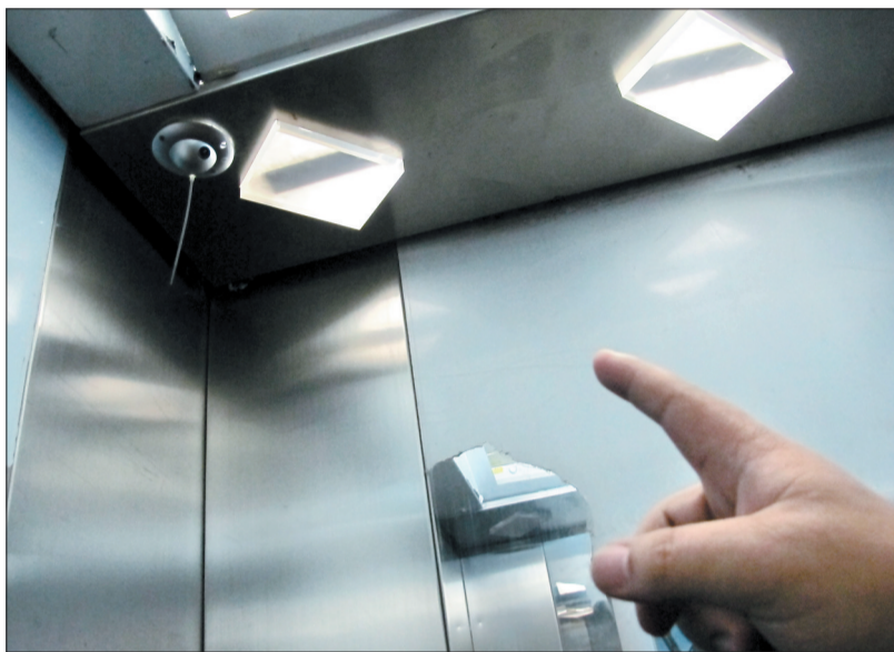
小区内电梯内此次新更换的监控摄像头
