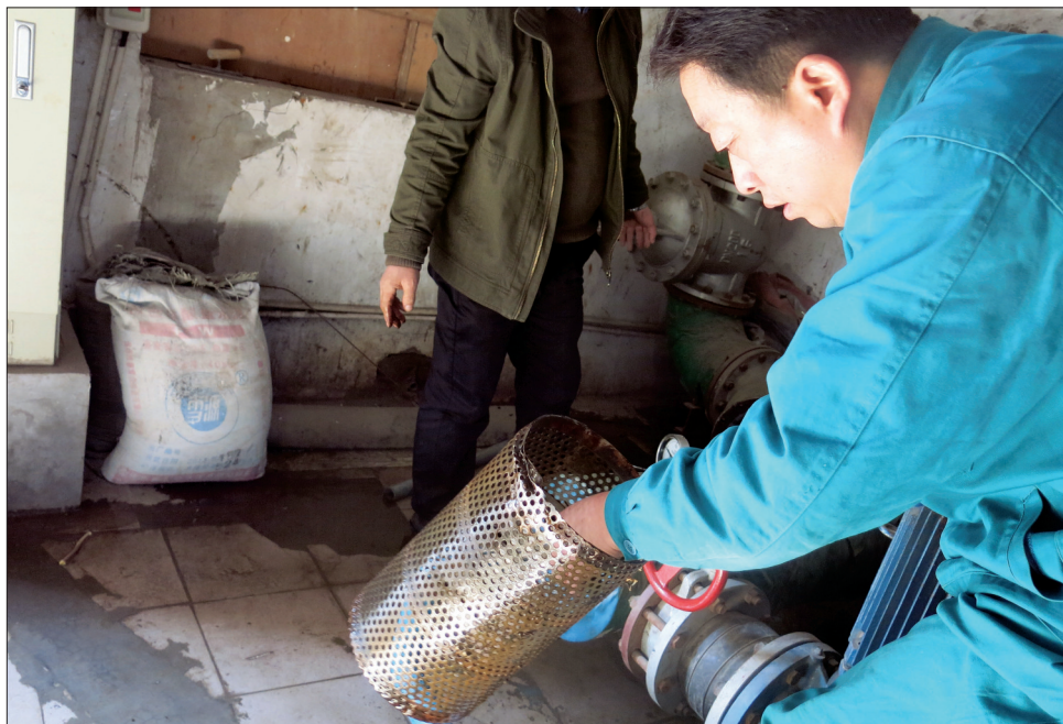
工作人员检查过滤网
