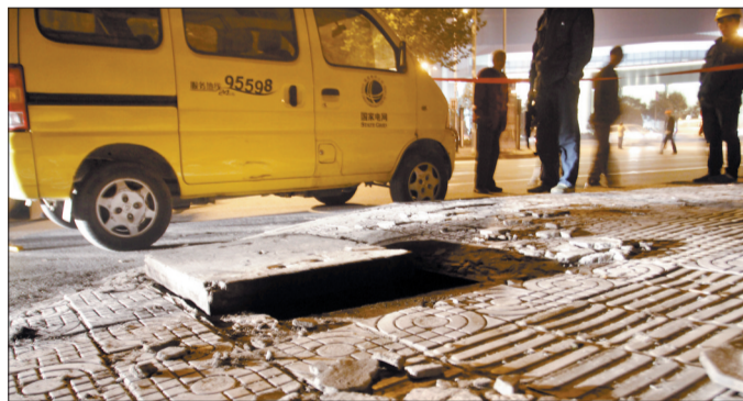
窨井口周围散落着水泥泥块
