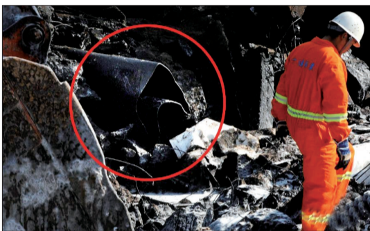
红圈处为断裂的输油管道,消防人员在断裂点附近检查 (网络图片)
