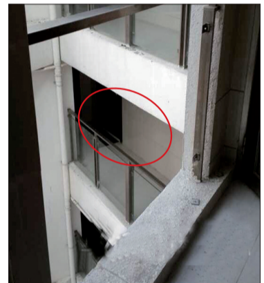
三十三层楼道露出巨大的缺口 (网络图片)
