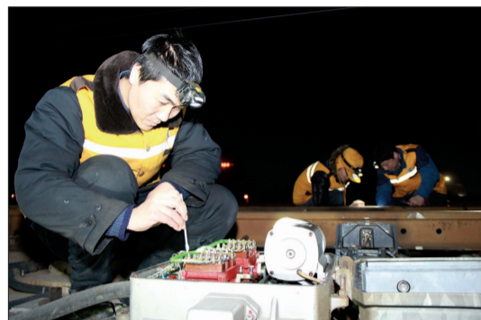
吕志刚(左)和工友们检查轨道上的信号设备
