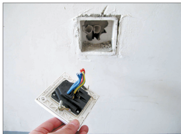
在刘先生的房子里,小偷将插座撬开后将电线一头剪断,然后从穿线管中将剩余部分抽出
