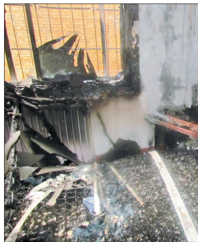
被烧得面目全非的卧室
