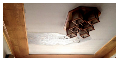
屋顶上一大片水迹
