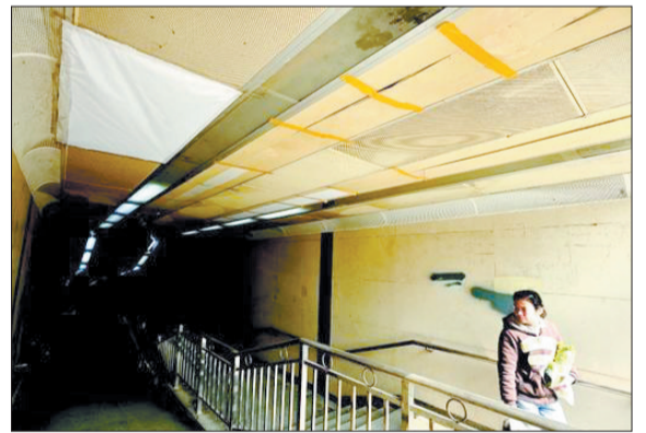
长港路地下通道吊顶用纸“维修” (网络图片)
