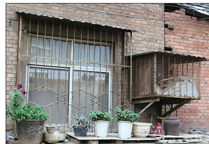
窗户旁的冷库制冷机室外机，看起来毫不起眼，开起来噪声却非常大
