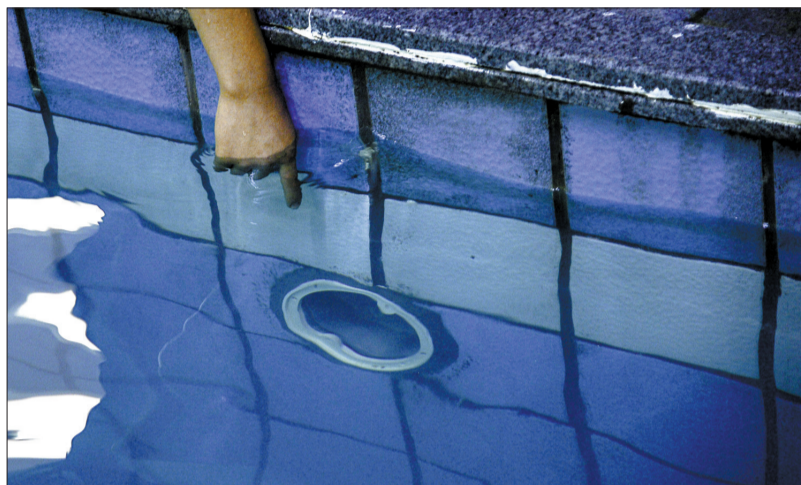
游泳池内的排水口
