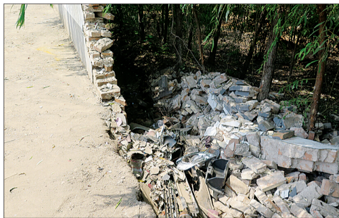
中国国花园北侧面围墙被撞出的缺口
