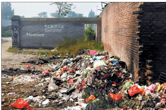
垃圾堆旁的墙壁已被熏黑
