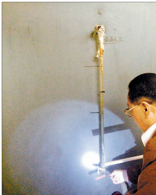
小区热力站内的水箱表示「管道漏水严重时，水位常常就到这里」
