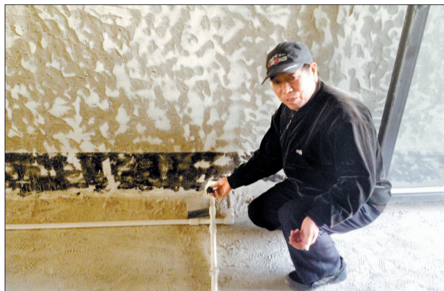
梁先生指着接入其房中的热力管道
