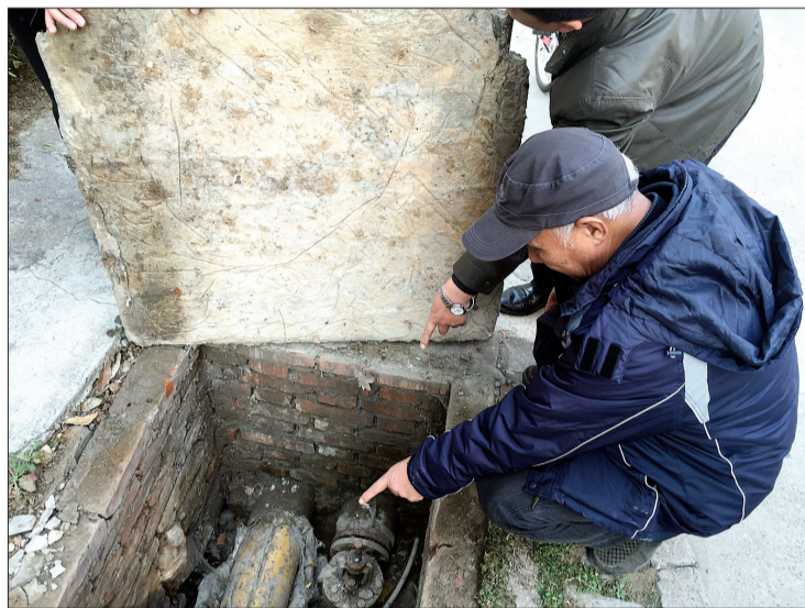
热力公司工作人员和小区业主指示物业私改的热力管道
