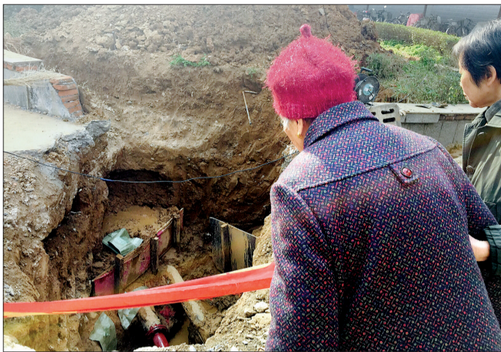
该小区南院业主路过的故障管道的土坑,都会探头往里看看,期盼自家能够早点儿暖和起来
