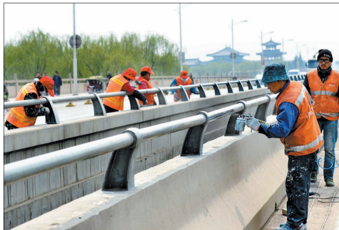
昨日,在洛阳桥上,市政建设集团的施工人员正在为桥梁喷漆刷新 记者 李卫超 通讯员 贾光明 摄
