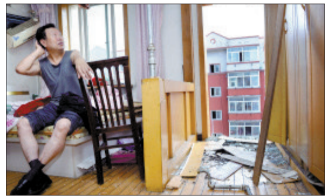
阳台坍塌,房主一脸后怕(网络图片)
