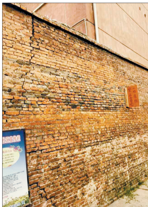
危墙上的裂缝十分明显
