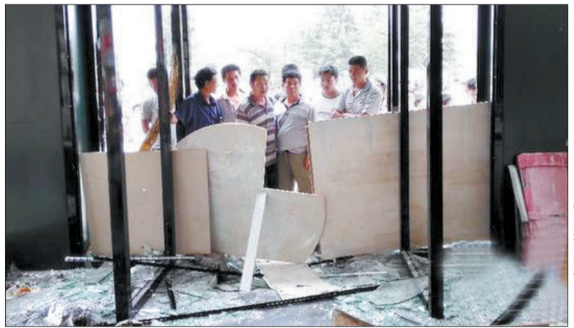
爆炸点附近一处店面正门玻璃被震碎
