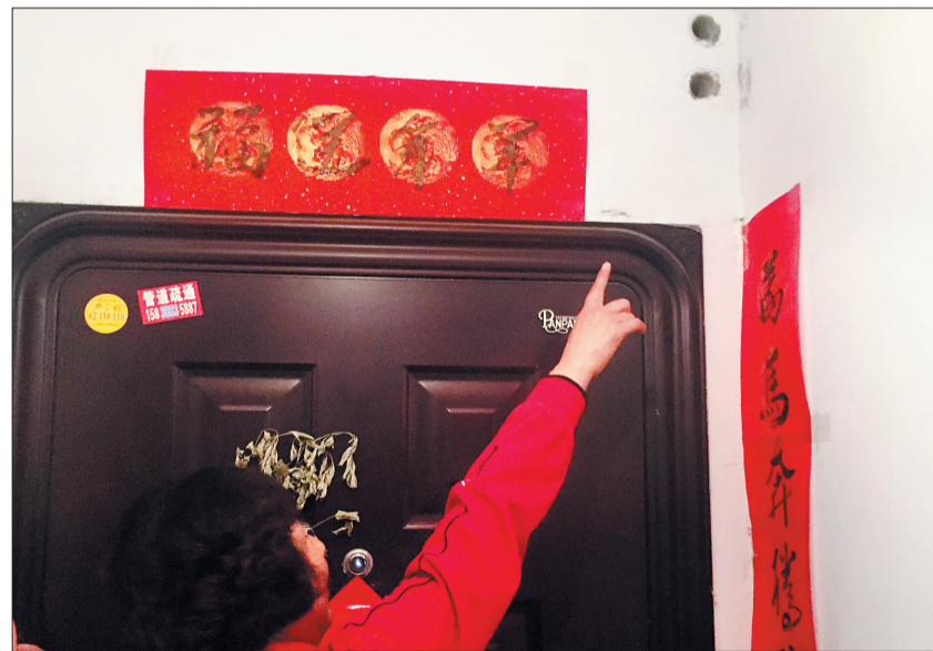
业主家防盗门上面的墙上钻出了准备安装热力管道的孔,业主抱怨“影响美观”
