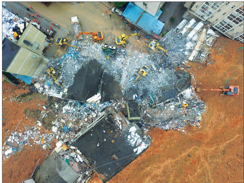
12月21日从空中拍摄的深圳山体滑坡救援现场
