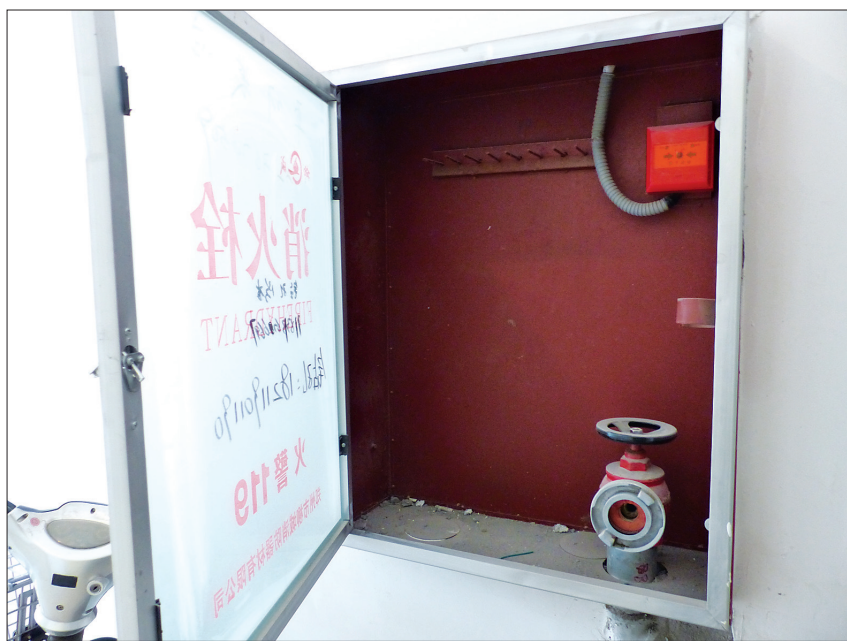
消火栓箱内,消防器材严重缺失
