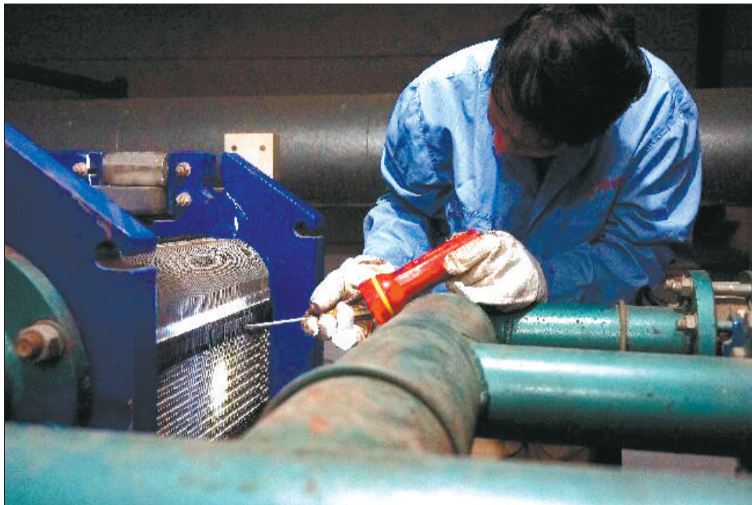
热力运行人员对香榭里定鼎广场热交换机组进行检查维护
