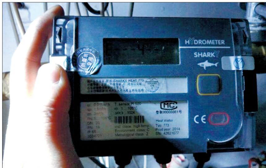
被张某拆除的邻居家的供热设备
