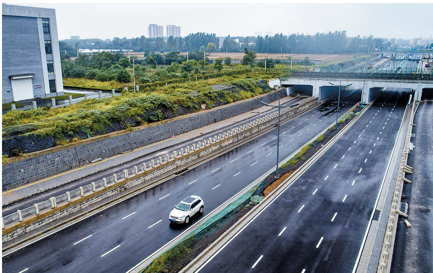
安居路两侧路灯、标线施工均已完成,今日正式放行 记者 梅占国 刘冰摄
