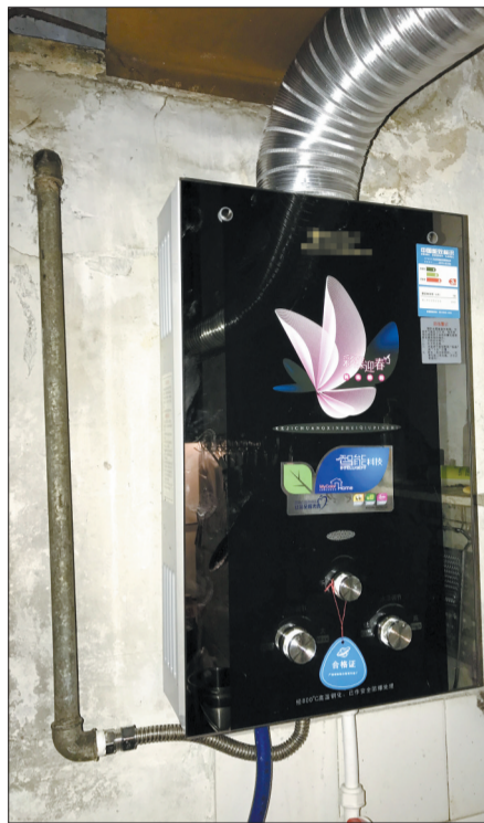
发生意外后,老人家中换了一台新的燃气热水器
