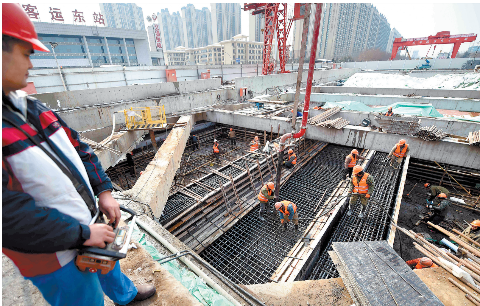
史家湾站最后一段顶板混凝土浇筑马上就要完成 记者 张怡熙 摄
